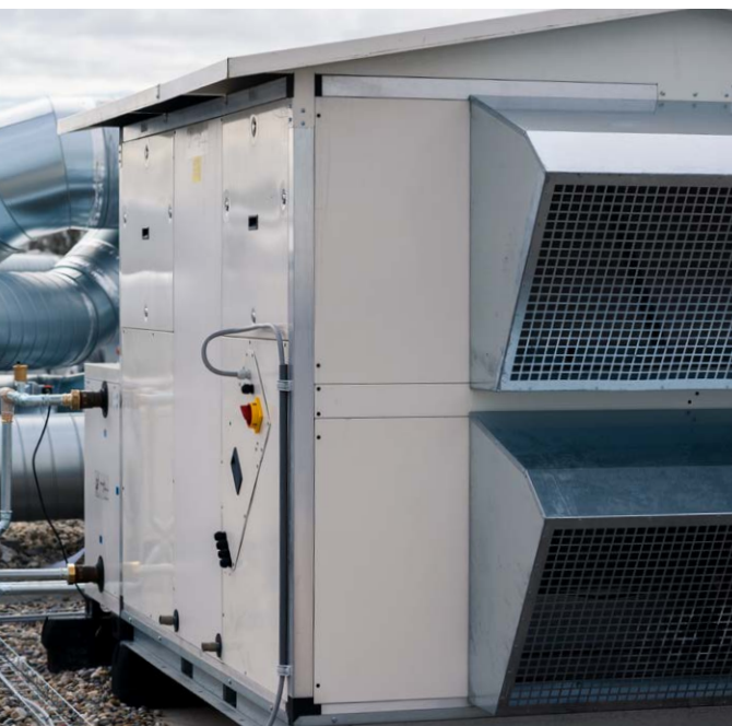
Een van de geplaatste luchtbehandelingskasten, gekoppeld aan de professionele keuken.
