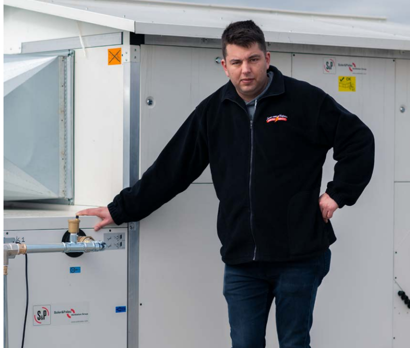
Jacco van Halteren bij een van de luchtbehandelingskasten van S&P.
